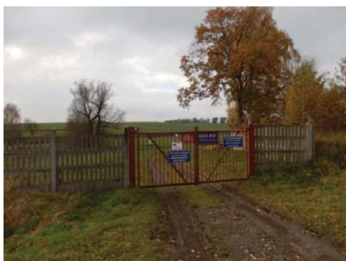
Fot. 11. Ujęcie wody w Pisarzowicach
