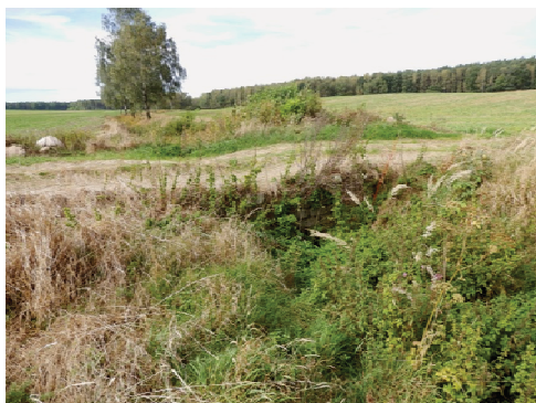
Fot. 17. Złoty Potok w Henrykowie Lubańskim wskazany do konserwacji, przepust wymagający remontu
