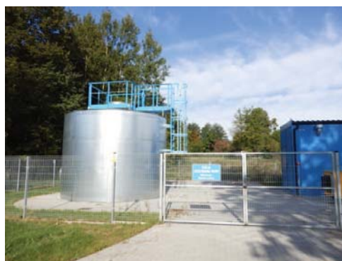
Fot. 12. Stacja uzdatniania wody w Henrykowie Lubańskim
